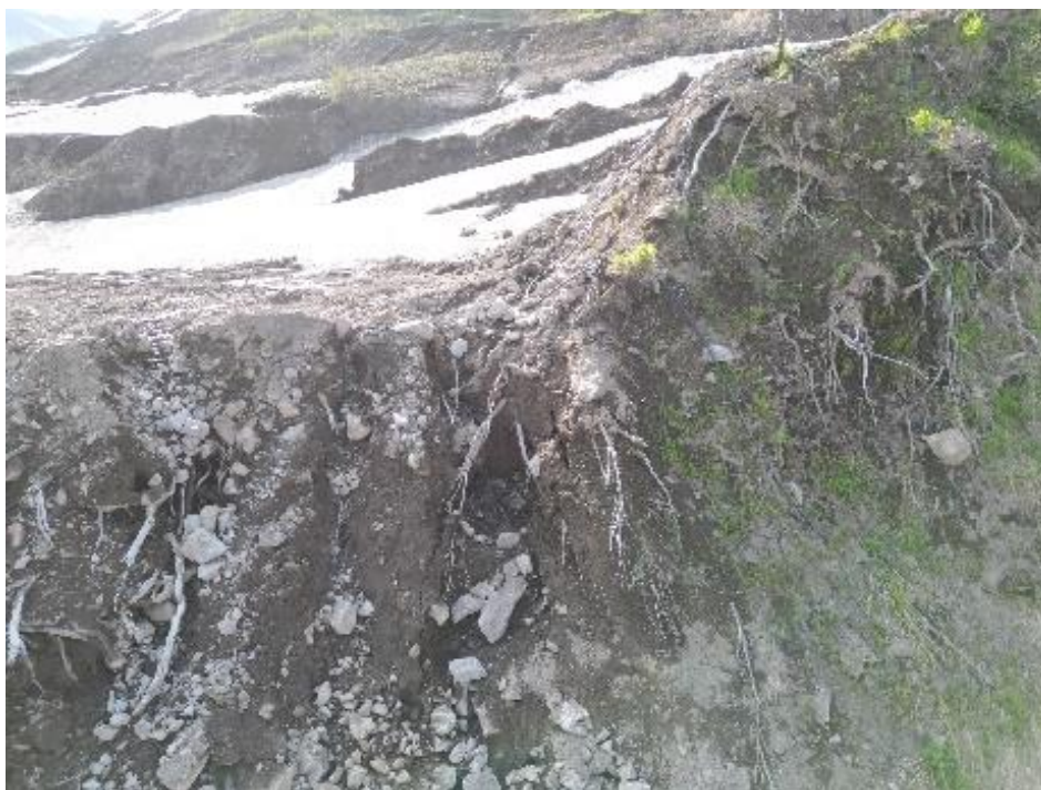
Илл. 147. Объект «Строительство горно-обогатительного комбината на месторождении Кумроч в Усть-Камчатском муниципальном районе Камчатского края. 1 очередь. Подземный рудник с объектами инфраструктуры». Точка фотофиксации № 37. Вид с востока
