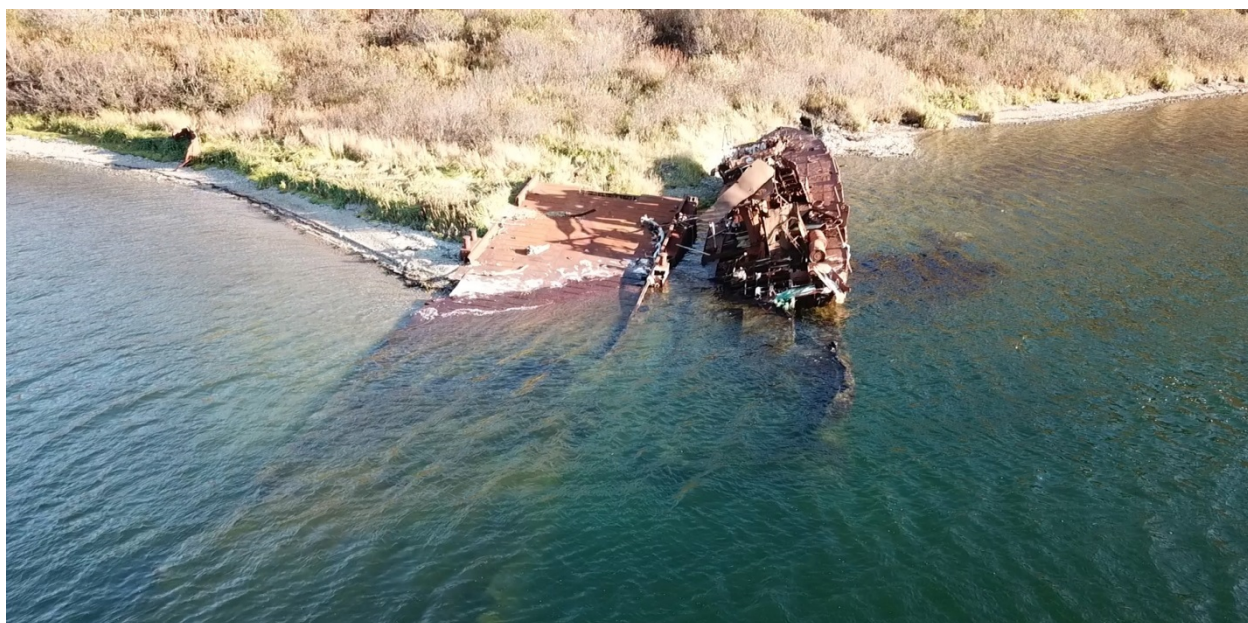
Рисунок 45. Разрушенный причал. Корпус судна. Вид с СЗ.
