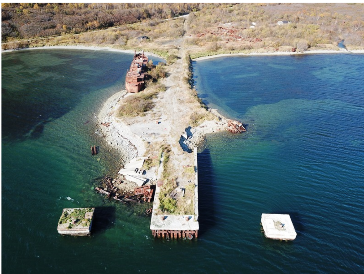
Рисунок 36. Разрушенный пирс. Корпус судна. Вид с ЮВ.
